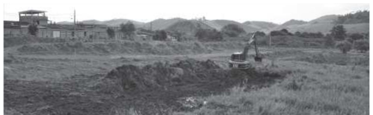
Obras no Vale do Ipiranga já foram iniciadas em terreno onde serão erguidos 600 apartamentos
